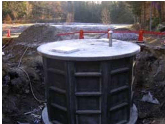
En av de nya brunnarna vid reningsverket. Foto: M. Svensson
